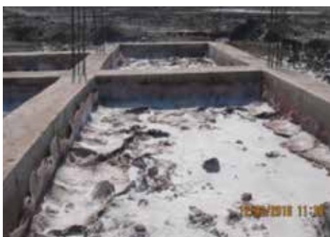
شکل ۶. خسارت وارده به فونداسیون ساختمان مسکن مهر به علت درصد بالای نمک خاک محل احداث
