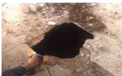
شکل ۴. تصویری از خالی شدن زیر فونداسیون ناشی از واگرایی خاک انحلال‌پذیر
