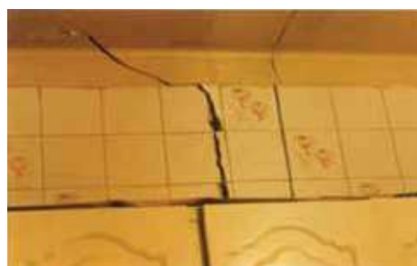
شکل ۳. تصویری از ترک‌های دیوار آشپزخانه در خانه‌های جزیره هرمز ناشی از واگرایی خاک گنبدهای نمکی
