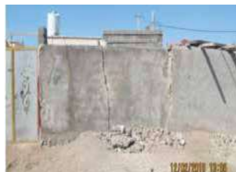
شکل ۵. تصویری از ترک‌خوردگی دیوار ساختمان‌های مسکونی جزیره در اثر فرونشست خاک زیر پی
